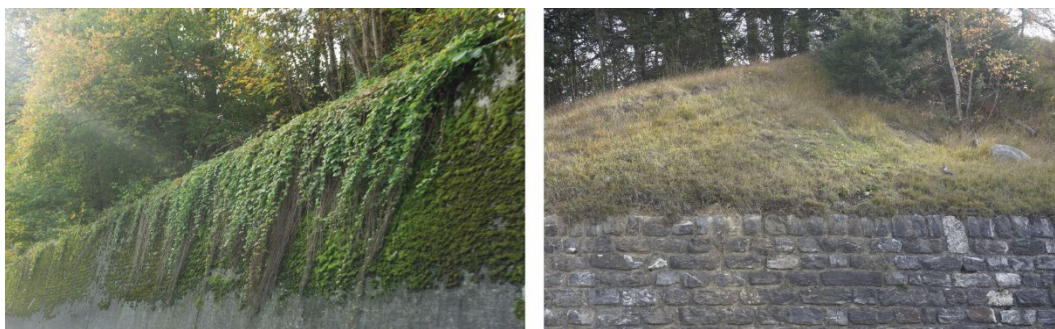
Ill. 34 Végétation au-dessus de l'ouvrage
