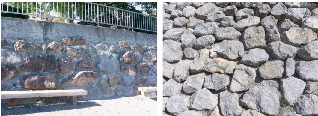
III. 12 Absence de couches des enrochements
