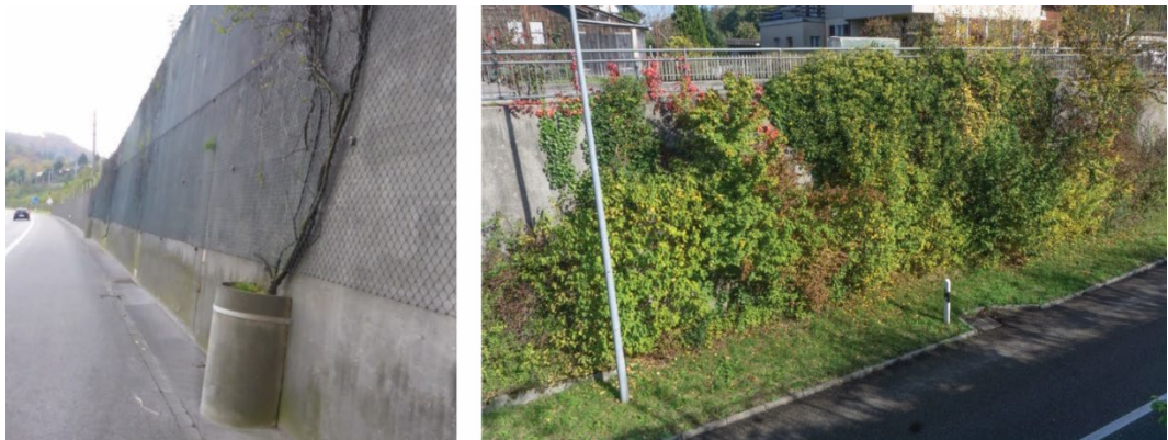
Ill. 30 Disponibilité de la terre pour la végétalisation d'ouvrages.
