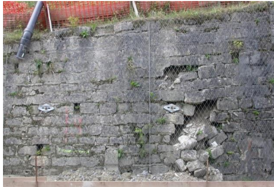
Photo 20 : Nids de pierres libres (danger d'effondrement malgré pierres intactes)
