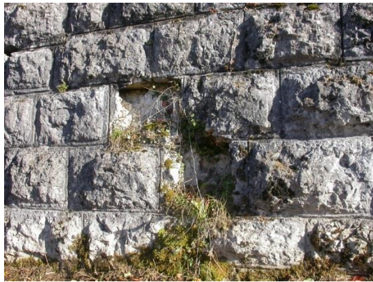
Photo 22 : quelques pierres fortement détériorées (effritement de pierre à chaux)
