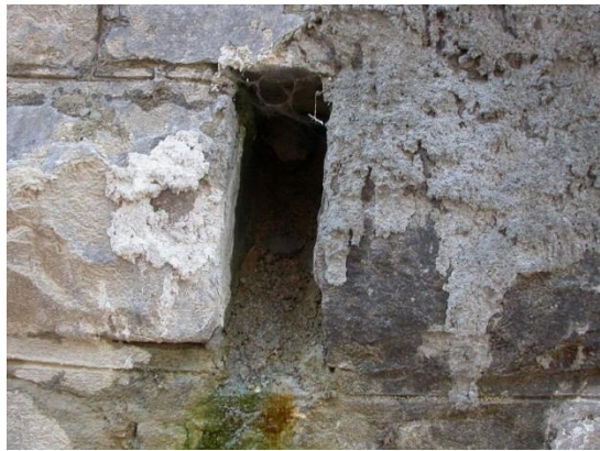
Photo 4 : Débris de mortier dans drainage
