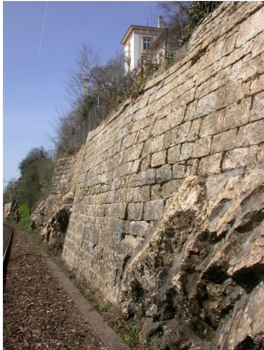
Photo 10 : Déformation claire (gonflement)
