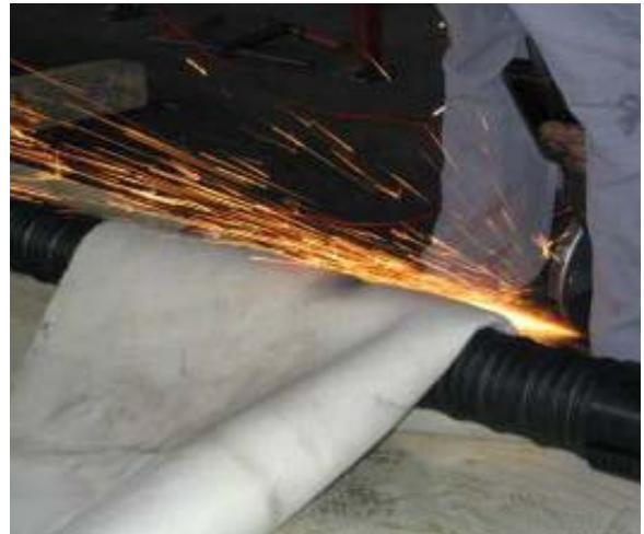
Fig. II.18 Nette de protection mise en place durant le travail avec une meule à disque.
