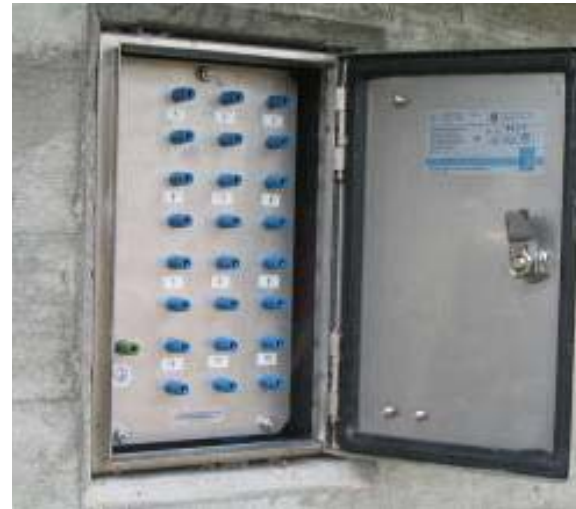
Fig. II.23 Coffret de mesure robuste en matériaux résistant à la corrosion.
