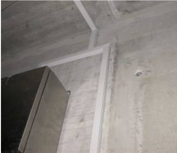
Fig. II.15 Installation subséquente en saillie p.ex. dans des chambres de culées protégées et fermées.
