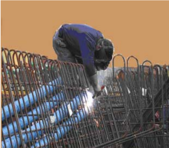
Fig. II.17 Soudage sans mesure de protection est interdit.
