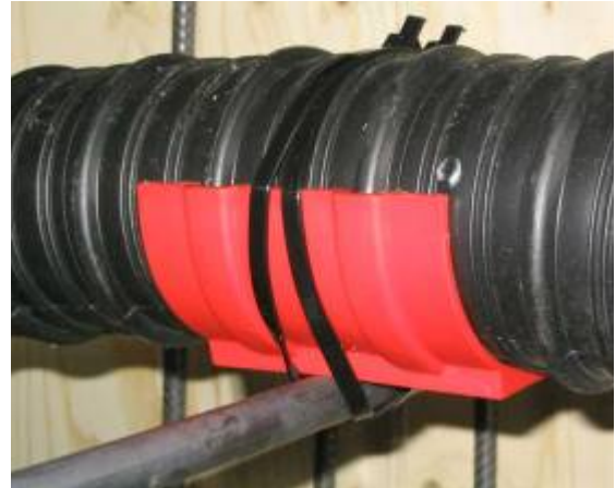
Fig. II.12 Coques de protection et ligatures en matières synthétiques.
