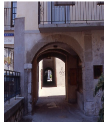
Un esempio di best practice: un’antica scorciatoia collega due strade passando attraverso un edificio Chambery, Francia
