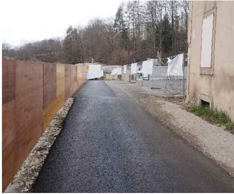
Figure 13 - E) Passage pour navettes
