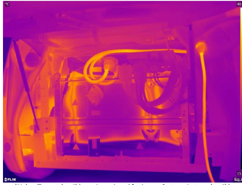
Figure 48 - Echauffement du câble après 15 minutes
