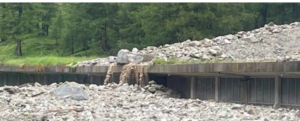
Alla fine di giugno 2024, una colata detritica sul passo del Sempione si è abbattuta sulla strada nazionale ed è penetrata nella semigalleria Engi.
