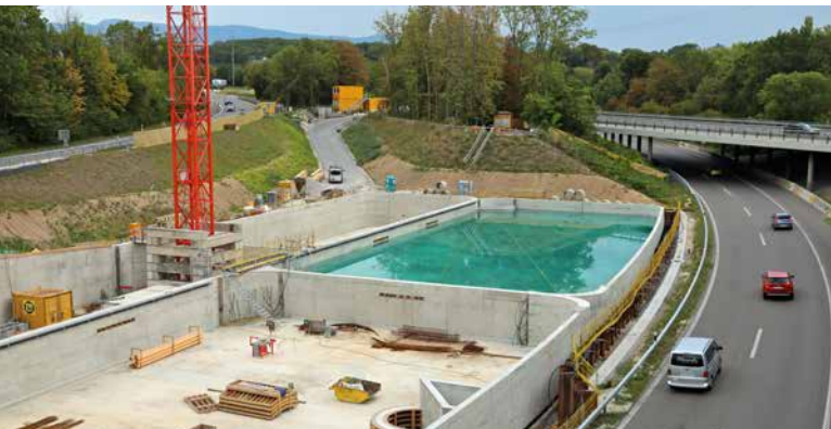
Sull'A9, tra Vennes e Chexbres (Cantone di Vaud), viene realizzato un nuovo impianto di trattamento delle acque stradali di scarico (SABA).
