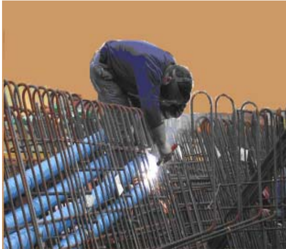
Fig. II.17 Soudage sans mesure de protection est interdit.
