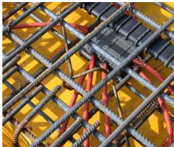
Fig. II.16 Tubes vides pour câbles de raccordement et de mesure.
