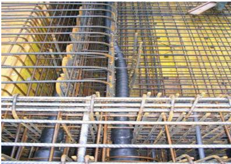
Fig. II.8 Passage en S câble de précontrainte/étrier pas pris en compte dans le plan d'armature, pas de coques de protection contre les étriers à l'intérieur de la courbe que fait le câble.
