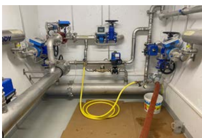
Project A9 Venness-Chexbres : l'OFROU contrôle la qualité de l'eau venant de la zone de protection.
