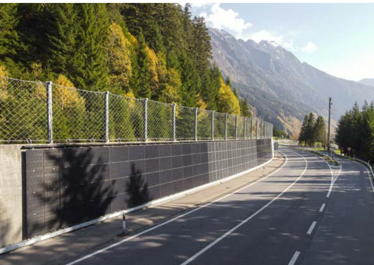
Installation expérimentale pour la production d'électricité au bord de l'A13, sur la route du San Bernardino dans le canton des Grisons.
