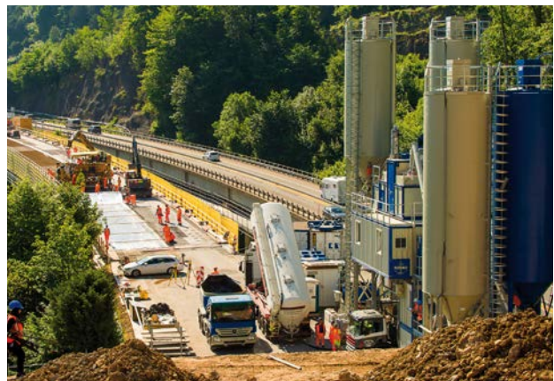
Remise en état au bout de 45 ans environ : rénovation des trois ponts de Boli, Mettlen et Linden au niveau de Küssnacht (canton de Schwytz)
