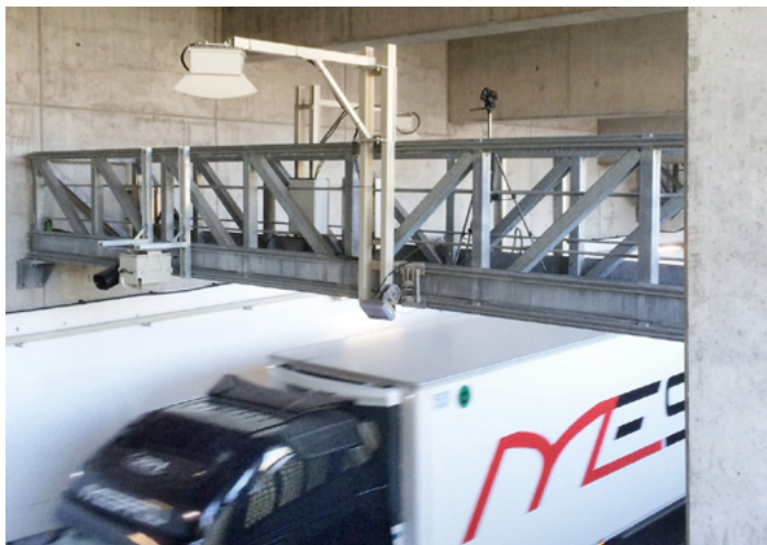
Ci-dessous: des installations de monitoring des marchandises dangereuses au col du Simplon
