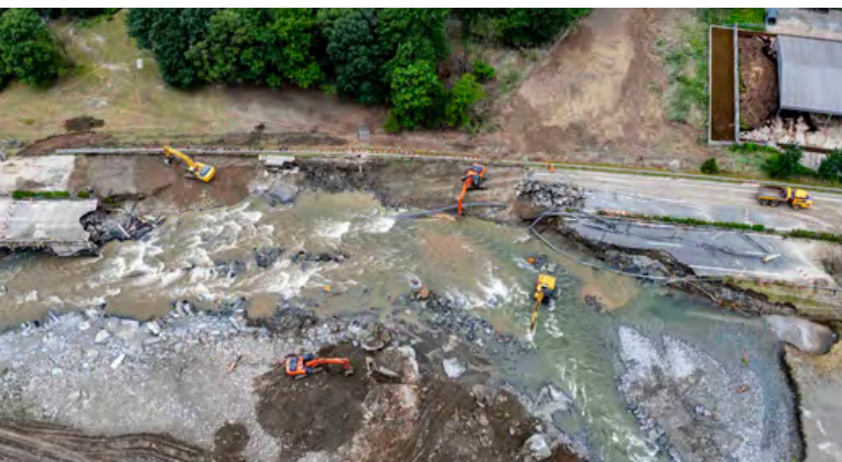
Au cours de l'été 2024, l'autoroute A13 a été emportée par les eaux dans le Val Mesolcina, dans le canton des Grisons.
