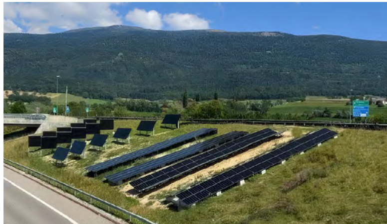
Test : l'OFROU évalue l'utilisation du photovoltaïque sur les talus de l'autoroute A16 près de Delémont-Ouest.
