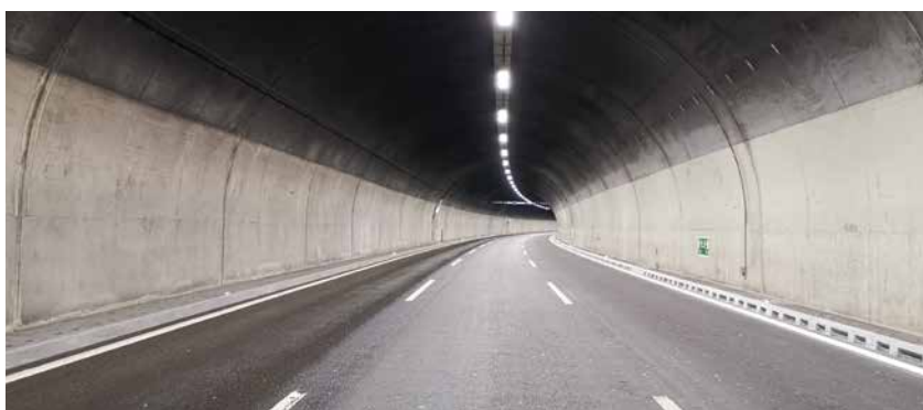
Éclairage LED dans le tunnel du Monte Ceneri.
