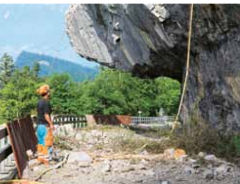
Une couche de sable et des plaques d'acier protègent la glissière en cas d'éboulis.
