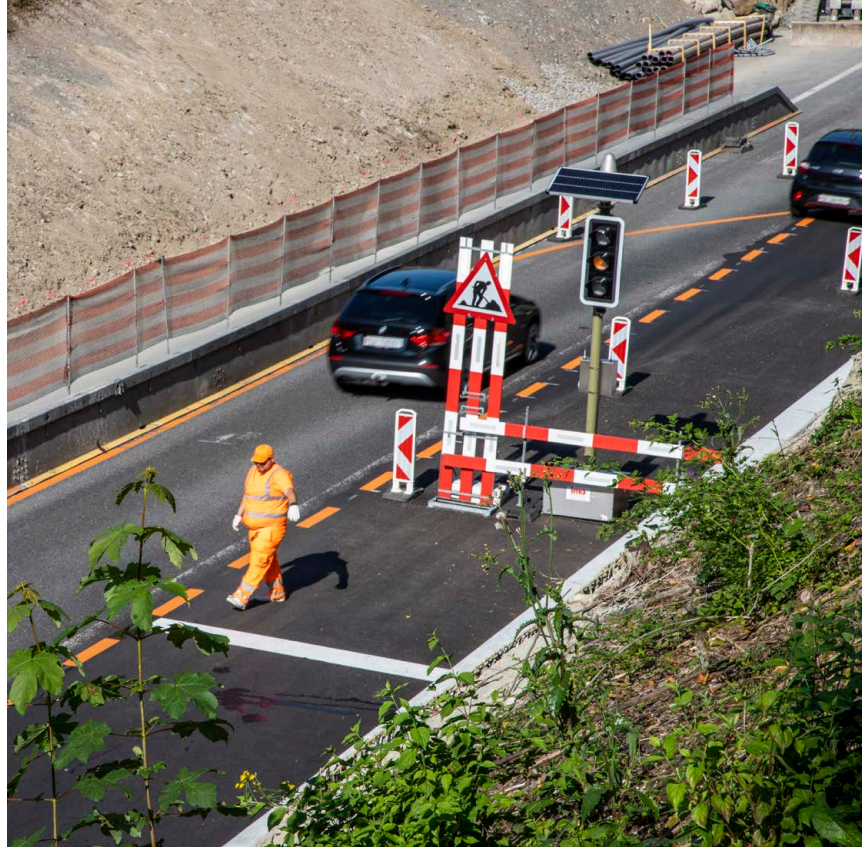
Fermeture de voie sur l'A8 dans le cadre du projet d'entretien entre Interlaken-Ost et Brienz
