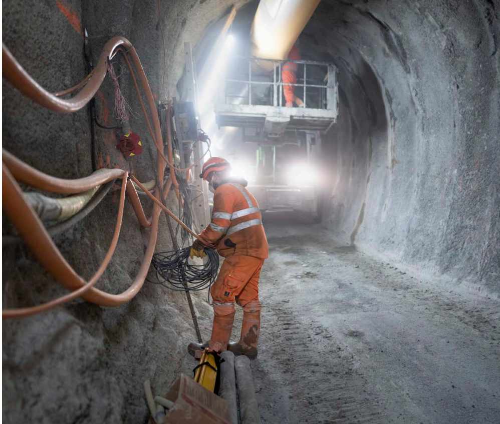
Travaux de prolongation de la galerie de sécurité du deuxième tube du tunnel routier du Gotthard à Airolo/TI.
