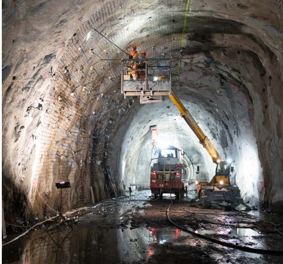
Travaux de sécurisation des parois de la caverne de montage, à partir de laquelle les mineurs creusent à l'explosif un tronçon de 300 mètres du deuxième tube du tunnel routier du Gotthard.
