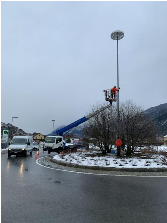
Illustration 6: Un système lidar fixe donnant des informations sur le trafic a été installé dans un rond-point d'une zone à forte densité de trafic.
