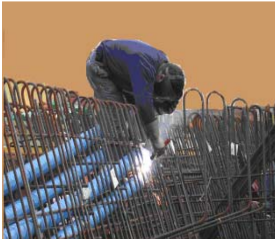
Abb. II.17: Schweißen ohne Schutzmassnahme ist untersagt.
