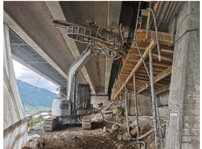
Es wurden bis zu 20 Meter tiefe Löcher ins Erdreich gebohrt, in welche später die Ankerlitzen eingeführt werden.
