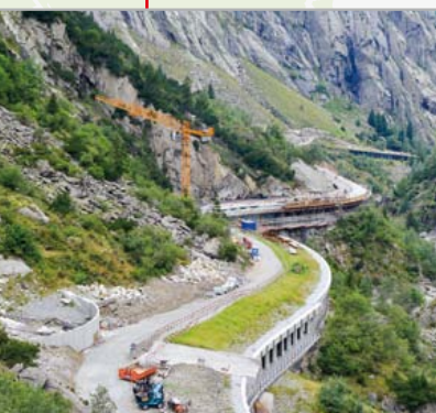
Tanzenbein: Bau des Trassees für Langsamverkehr in südlicher Richtung auf dem Dach der Matterhorn Gotthard Bahn, weiter in Richtung Bau des Trassees auf dem Dach der Tanzenbein.
