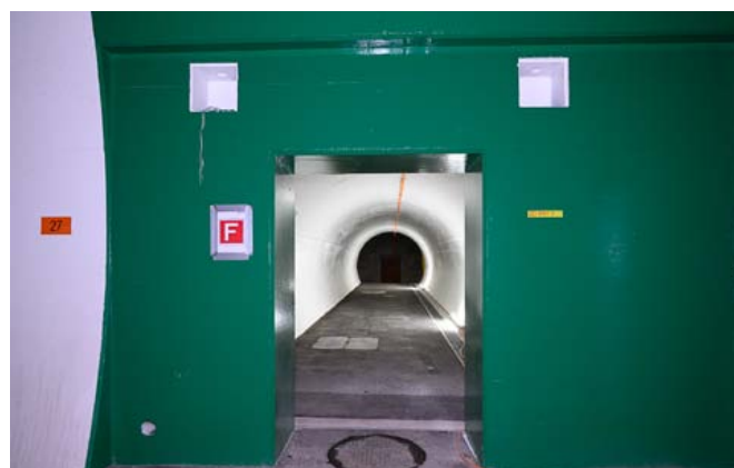
Besonders wichtig im Notfall: Die hell beleuchteten Querschläge, welche die Tunnelröhren verbinden und so einen sicheren Fluchtweg gewährleisten.
