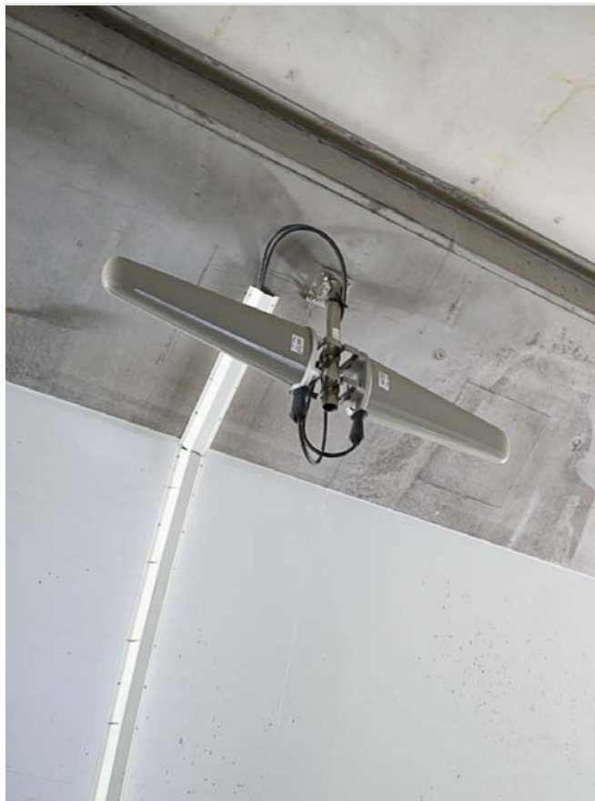
Antenne für Mobiltelefonie. Die Anlagen sind Eigentum der Mobilfunkanbieter.
