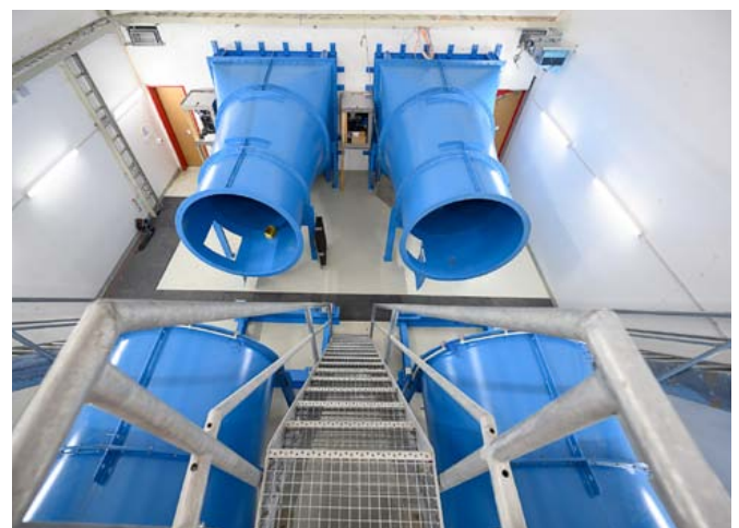
Abluftventilatoren an den beiden Tunnelportalen saugen die Abluft via Klappen und Abluftkanal aus dem Tunnelinnern.
