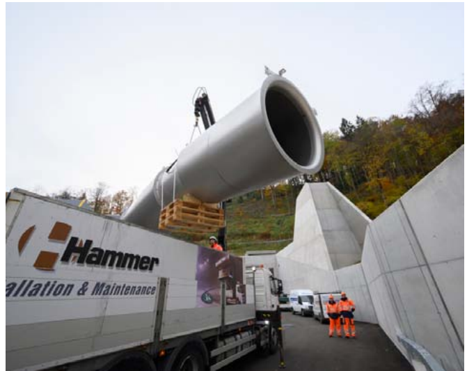
Mitte November 2019 wurden die Strahlventilatoren angeliefert und ...
