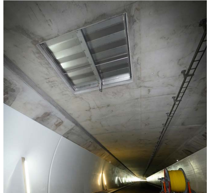
An der Tunneldecke befinden sich im Abstand von 100 Meter Abluftklappen, durch welche im Ereignisfall der Rauch in den Abluftkanal gesaugt wird.
