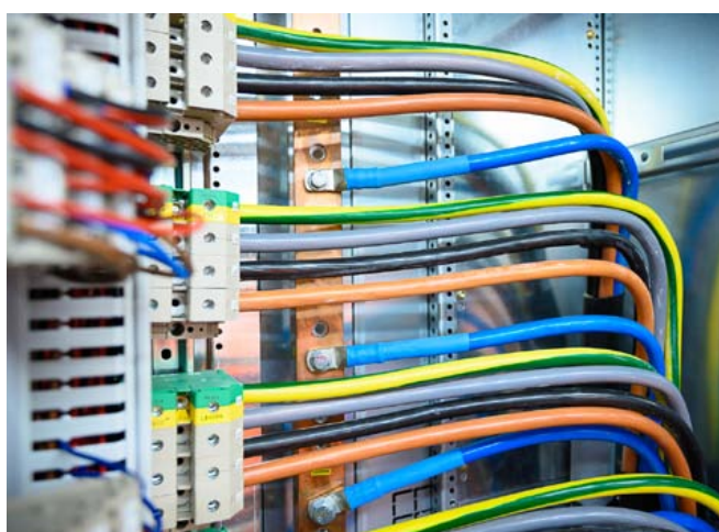
Abgänge der Niederspannungs-Energieversorgung in alle Zentralen.
