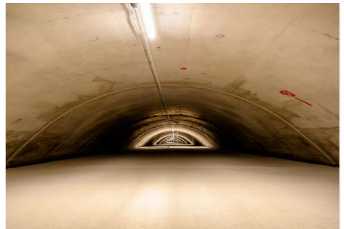
Ein Blick in den 2880 Meter langen Abluftkanal über der Tunneldecke.
