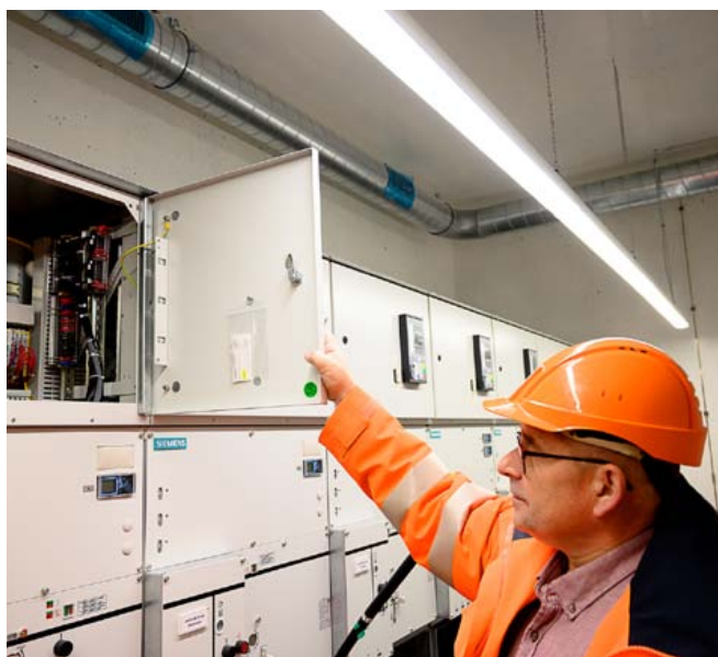
Mittelspannungsschaltanlage (16 kV) mit geöffnetem Steuerabteil.
