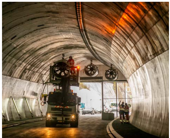
Während beim Südportal eine Dreier-Ventilatorengruppe montiert ist, sind es beim Nordportal gleich drei Dreiergruppen, die einsatzbereit sind.
