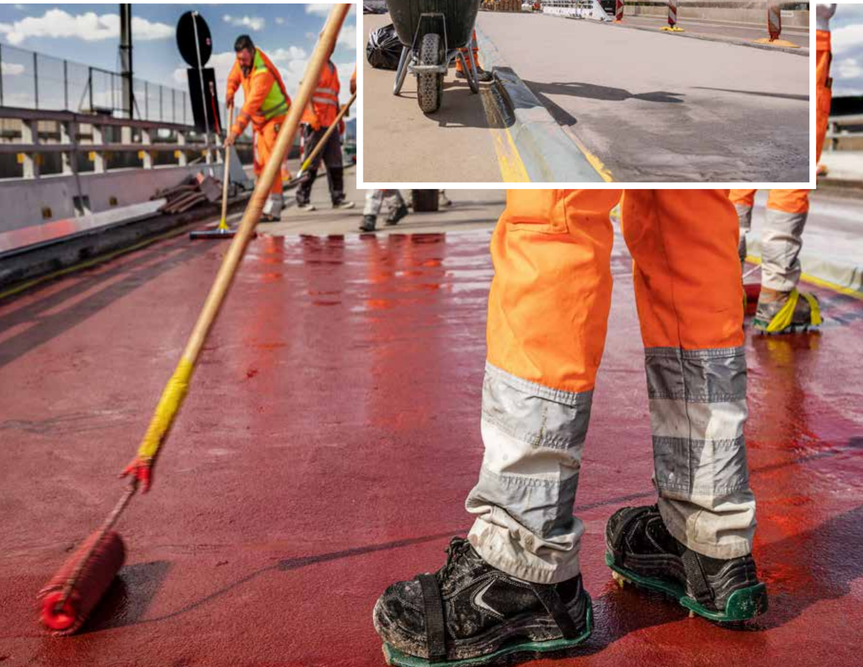
Der Haftvermittler für den Strassenbelag dient gleichzeitig als Decksiegel über den Dilatationsfugen.
