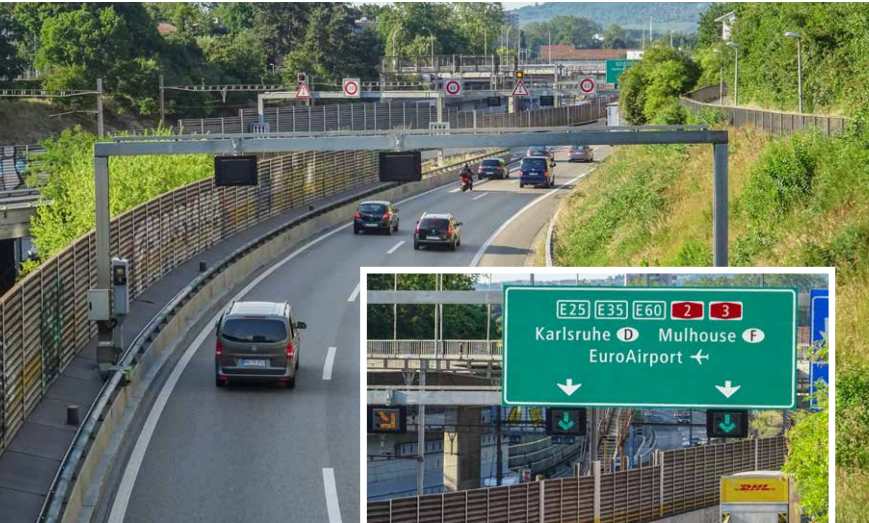
Über 100 Wechselsignale, Gefahren- und Fahrstreifensignale ermöglichen es, den Verkehrsfluss situativ zu verbessern.
