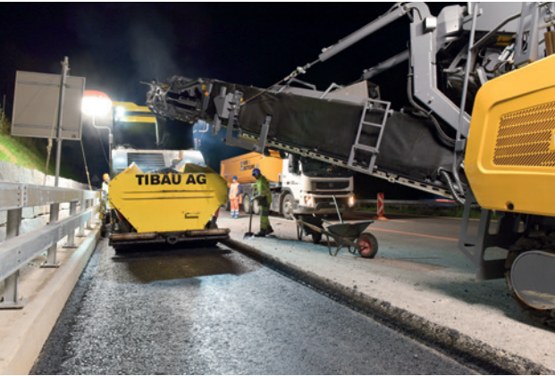
Belagsarbeiten in Fahrtrichtung Zürich, zwischen dem Anschluss Effretikon und der Verzweigung Brüttisellen.
