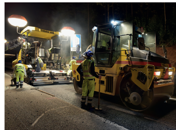
Belagsarbeiten in Fahrtrichtung Zürich, zwischen dem Anschluss Effretikon und der Verzweigung Brüttisellen, September 2017.
