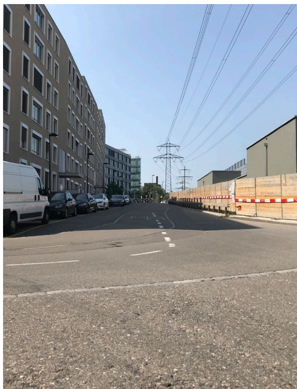
Die Bauarbeiten umfassen die Wiederherstellung der Beläge der Fahrbahn und des Gehwegs der Voisin-Strasse.
