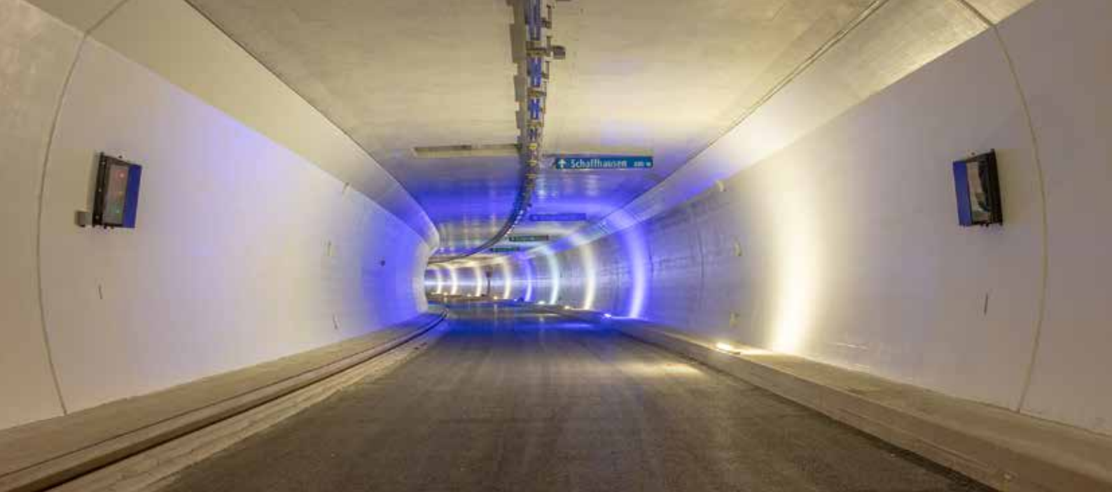
Das Tunnelinnere mit weit fortgeschrittener Betriebs- und Sicherheitsausrüstung (Bild: ASTRA Infrastrukturfiliiale Winterthur)
