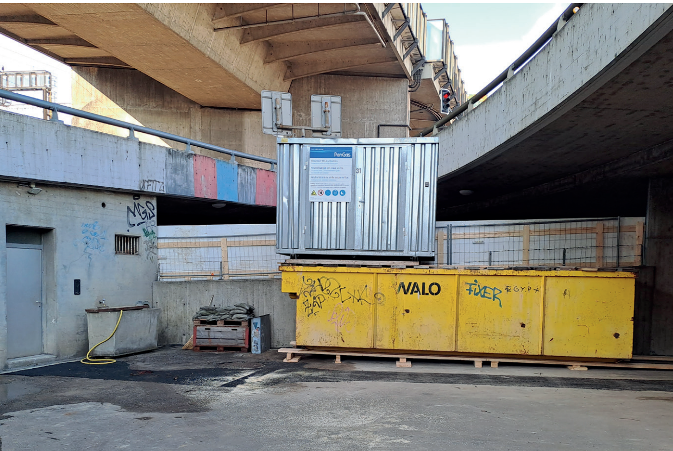
Absetzbecken mit aufgesetzter Begasungsanlage
