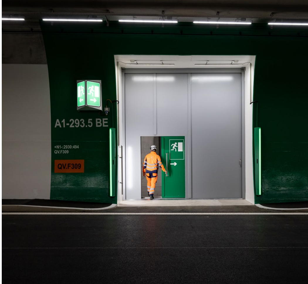
Accès à la galerie de secours dans le 3 e tube du tunnel du Gubrist.
